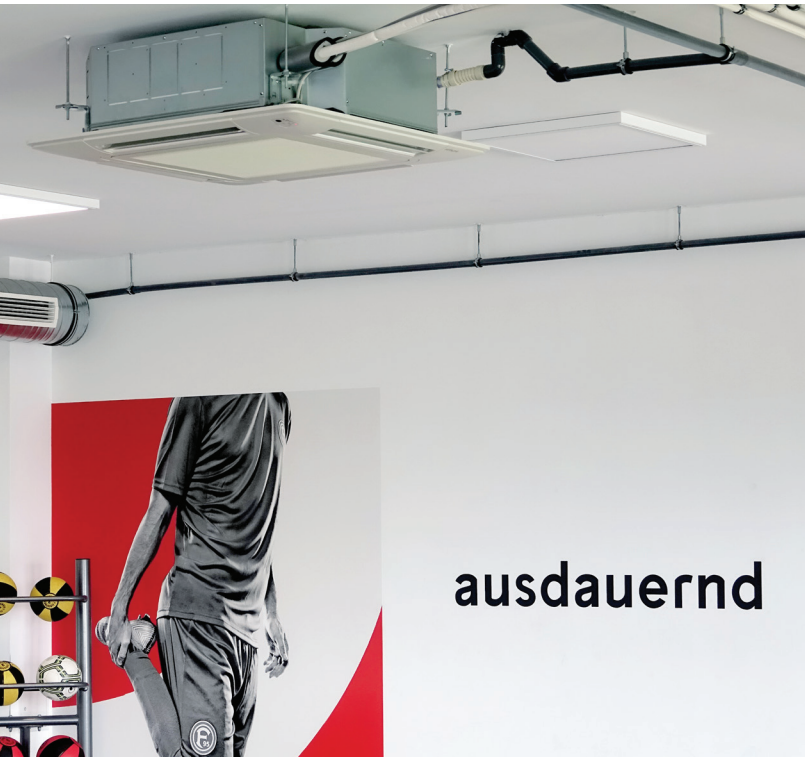
1. Im Trainingsraum montiertes 4-Wege-Kassettengerät von Hitachi
