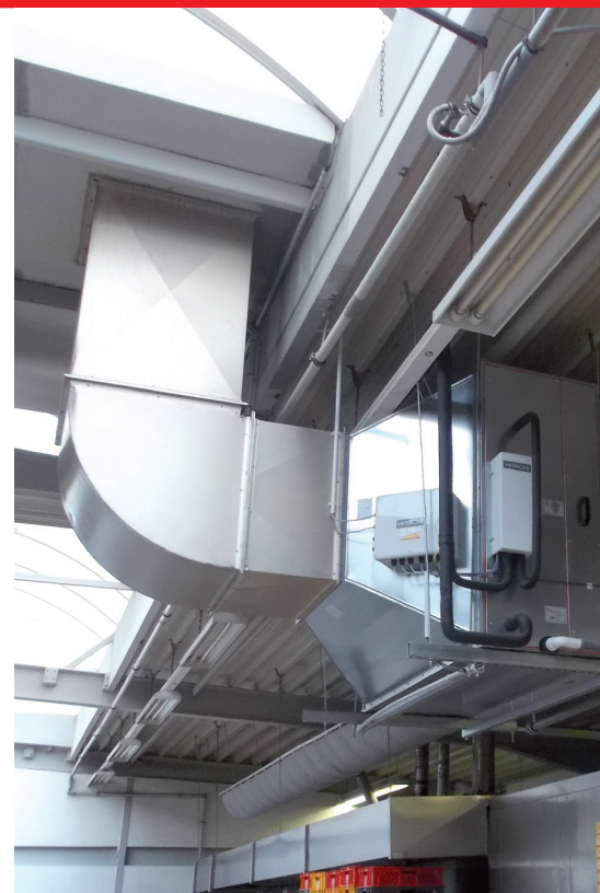
Hitachi-Steuereinheit in Kombination mit der bauseitigen RLT-Anlage
