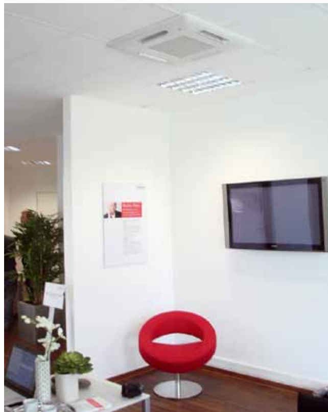
Hitachi 4-Wege-Decken-kassettengeräte Euro-Raster für die Büroräume der Hitachi Medical Systems GmbH.
