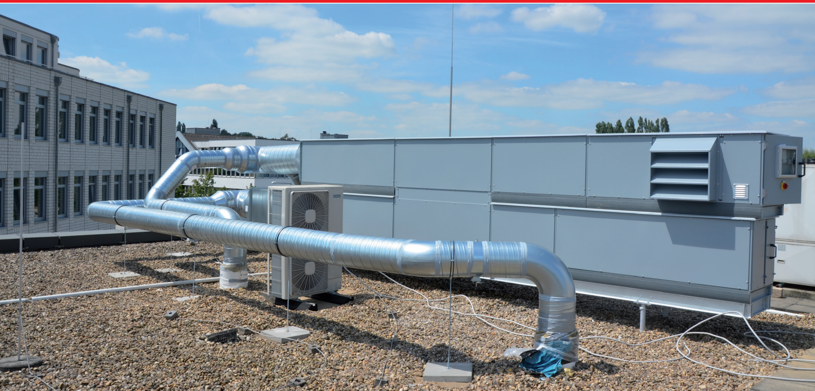
Kombination der Hitachi Utopia-Außeneinheit mit der bauseitigen Lüftungsanlage
