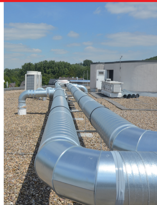
Eine ganzheitliche Lösung zum Heizen, Kühlen und Lüften mit Wärmerückgewinnung
